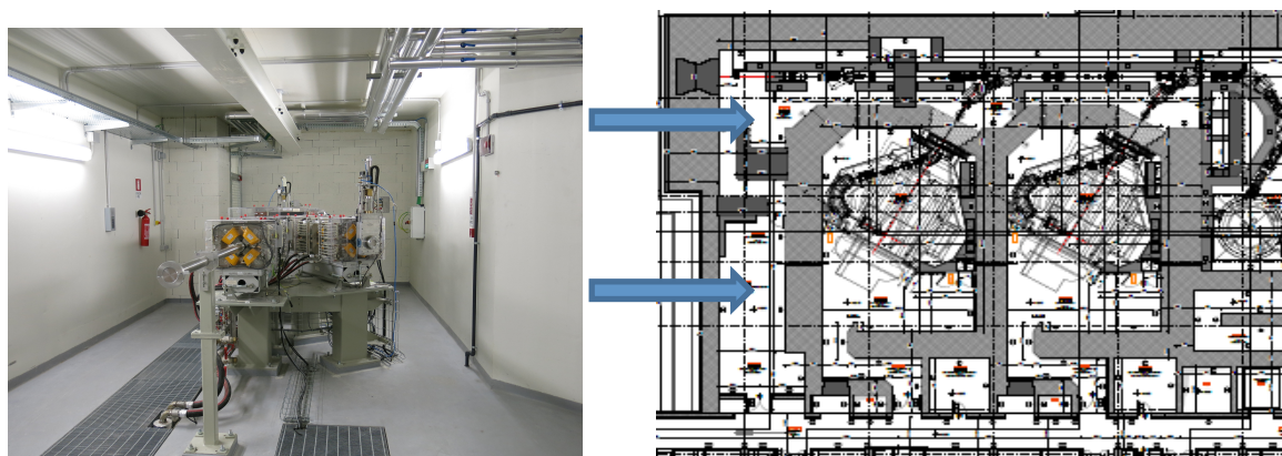
Fig. 6.8.1 Sala sperimentale TIFPA del centro di protonterapia APSS: le frecce indicano la collocazione della sala sperimentale e del laboratorio multifunzionale nel bunker.
